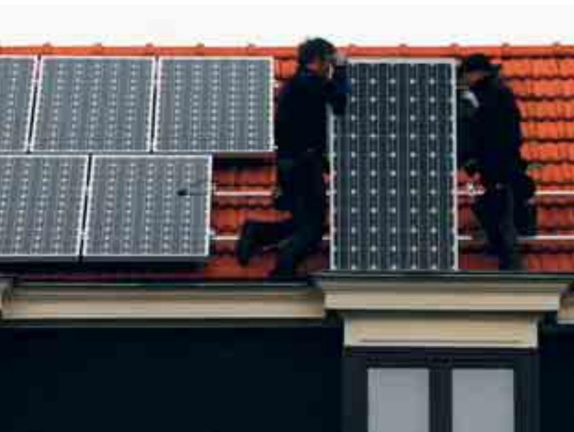
Zonnepanelen installeren is een lucratieve belegging geworden. © Johan Van Cutsem
